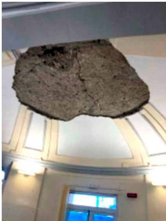
Figura 1- Quadro fessurativo volta
